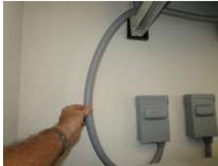
Loose conduit off HVAC unit
